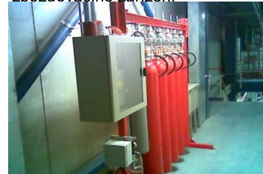
Stanice SHZ CO 2 včetně centrály a zpoždovacího zařízení
